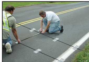
Mide la distancia adecuada al segundo tubo (si se utiliza). Asegura el tubo en el lado opuesto de la carretera.
